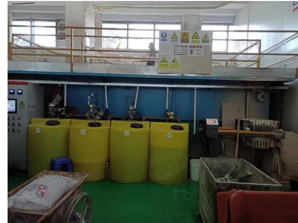
项目废水处理设施
