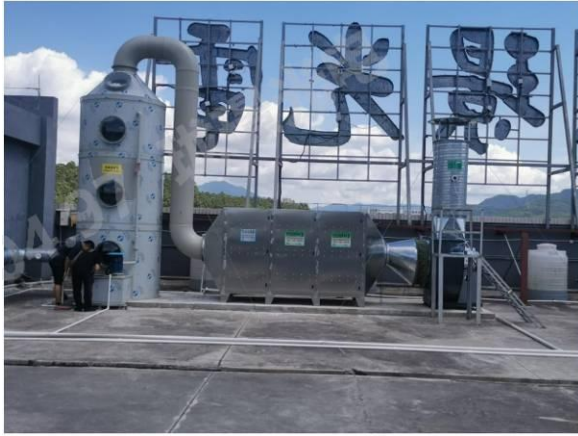
项目楼顶车间废气处理设施
