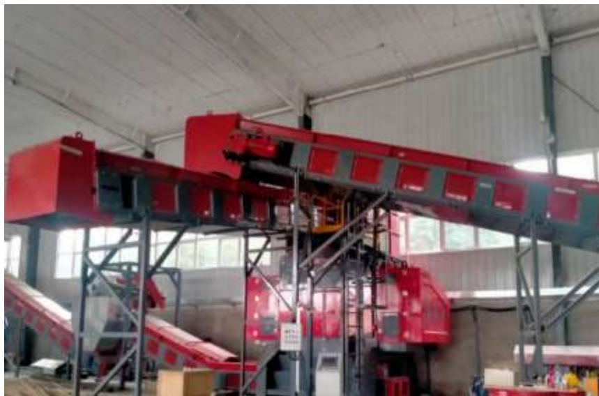
图 5 建设单位调研 RDF 生产设备图
